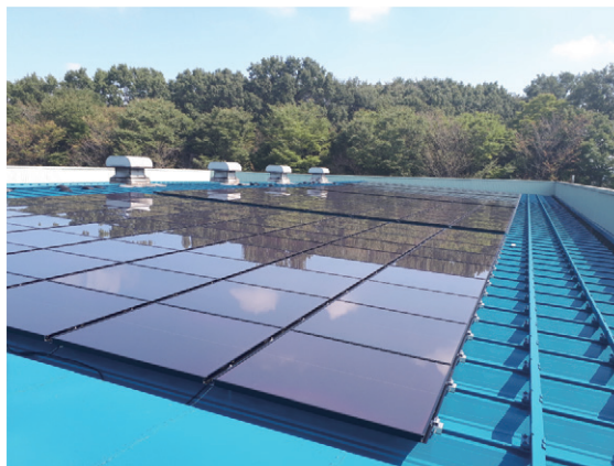
▲据置型ソーラーパネル
